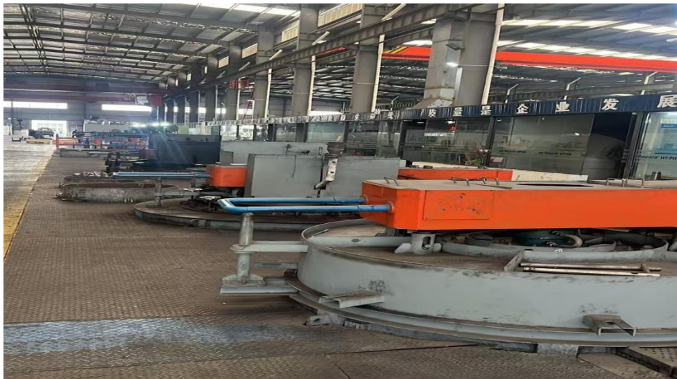
渗碳点燃装置
