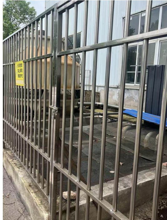
循环冷却水池
