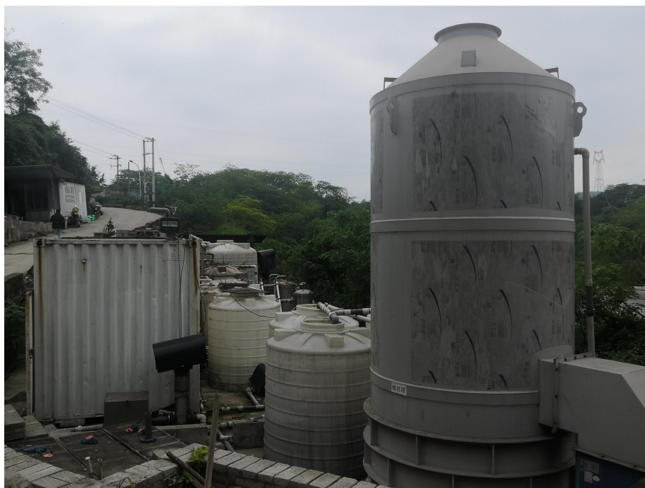
移动渗滤液处理站
