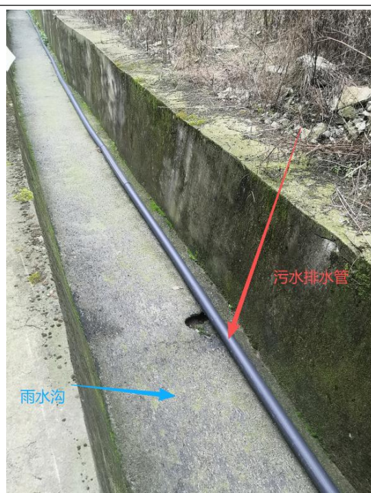
污水排水管及雨水沟
