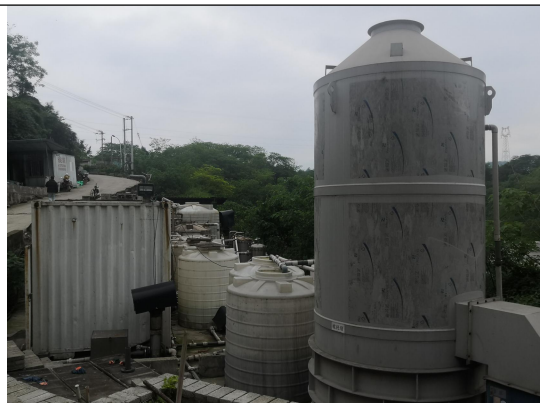
移动渗滤液处理站
