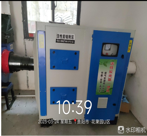
污水处理站废气处理设备（活性炭吸附设备，风量 1688~3517m 3 /h）
