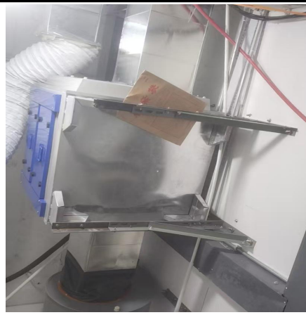
化验室废气处理设备（活性炭吸附设备，风量 5000m 3 /h）
