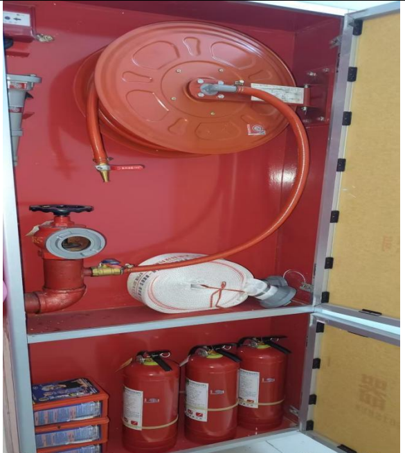
厂区消防设施
