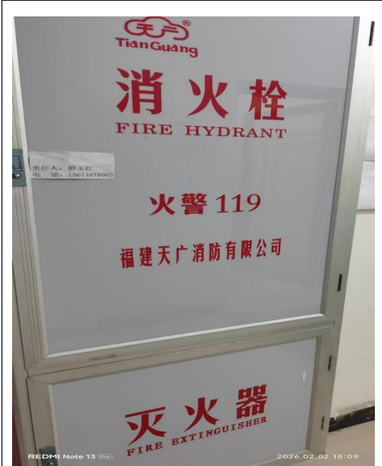
厂区消防设施
