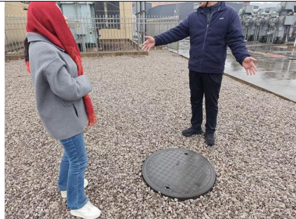
事故油池照片
