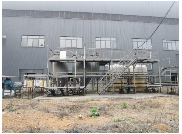
厂区污水处理设施
