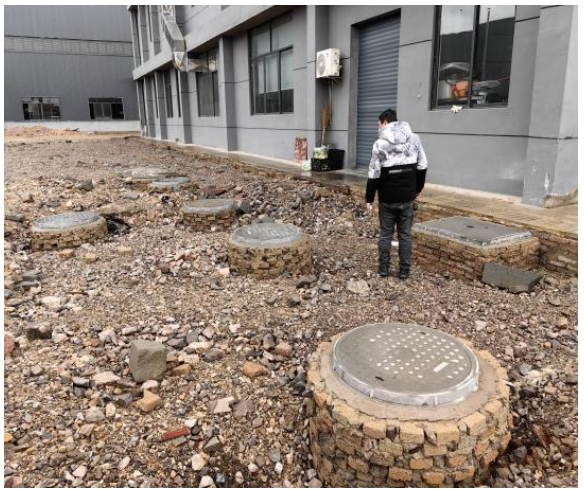
若干化粪池（约 60m 3 ）
