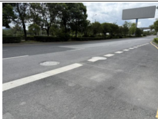
2 号化粪池接市政管网废水排放口
