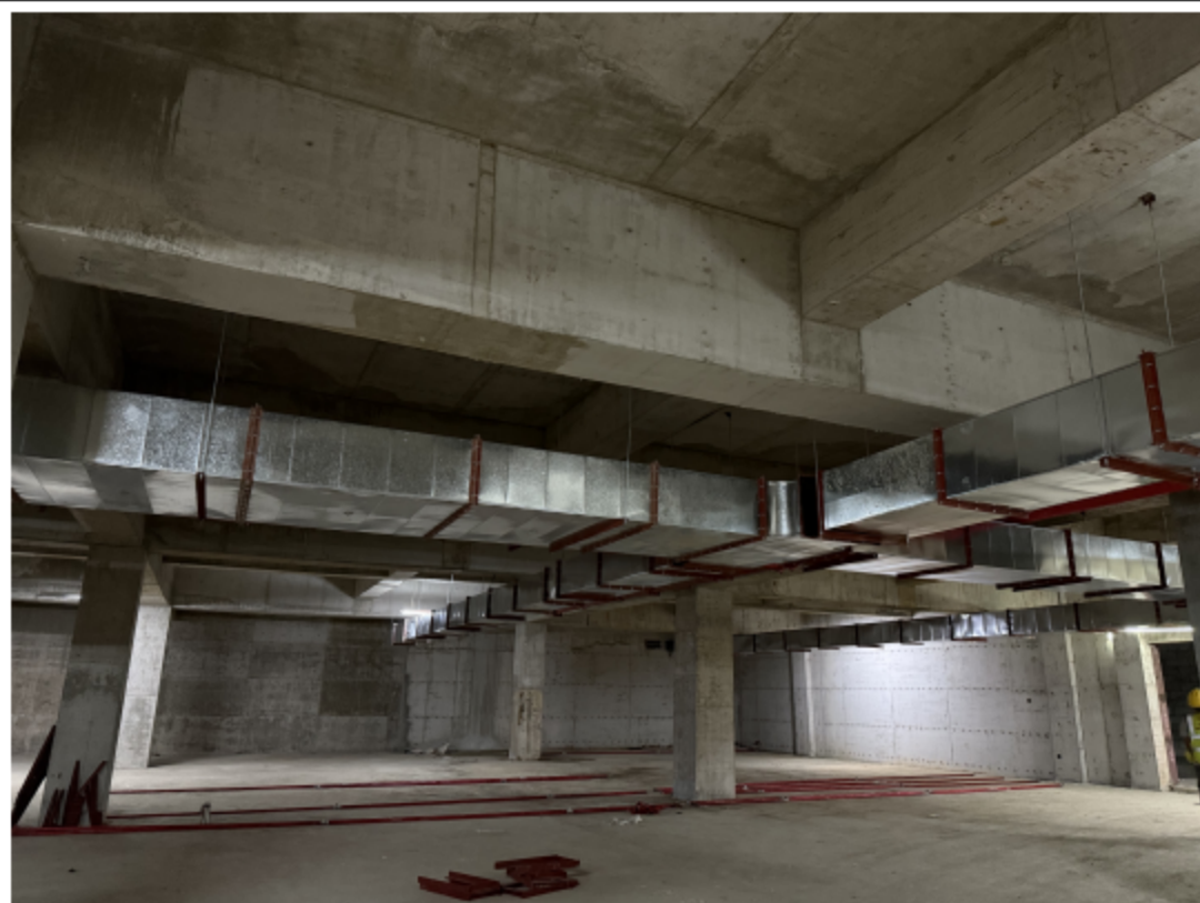
停车场换气管道
