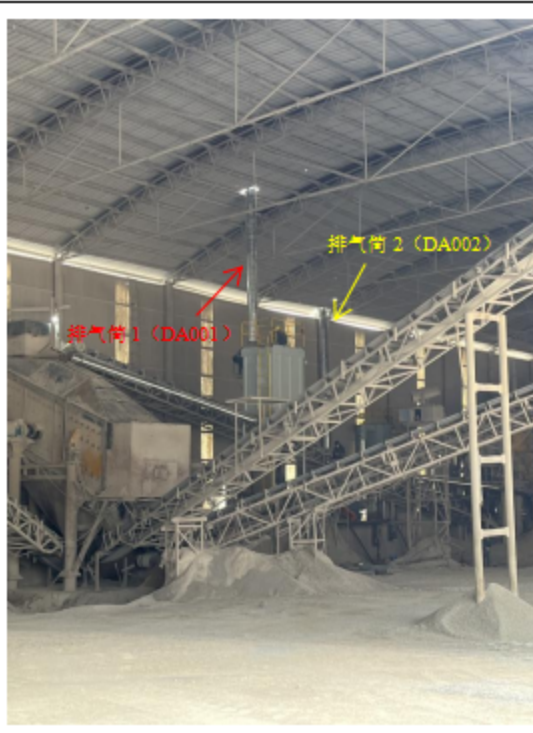
废弃石方资源化利用车集气设施和排气筒
