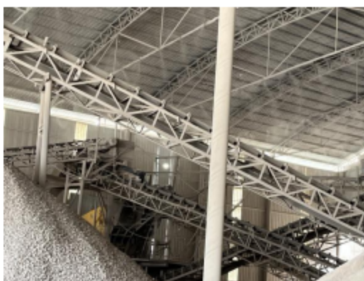
废弃石方资源化利用车间喷淋系统
