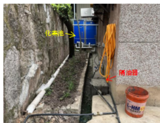
化粪池、隔油器+排水沟
