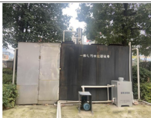
一体化污水处理设施
