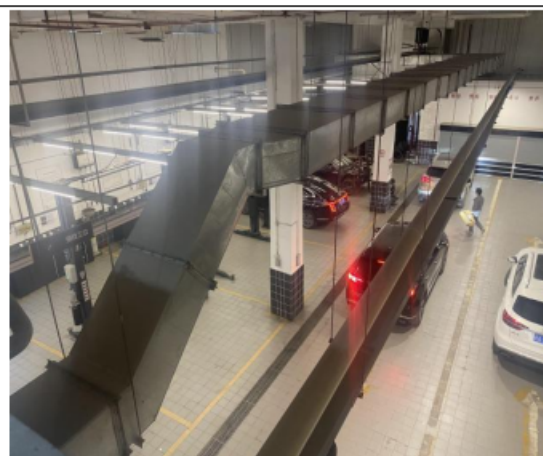
焊接车间通风设施
